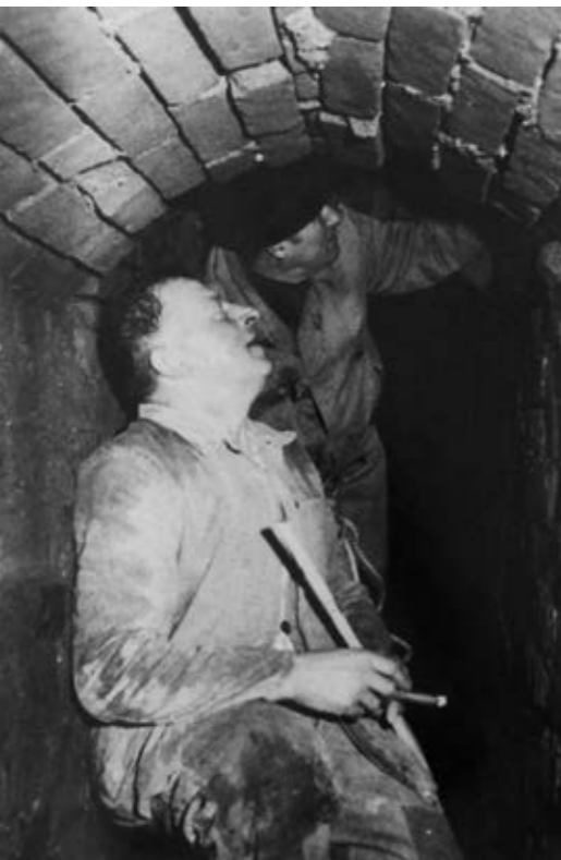
Einer der früheren Bausand-Bergwerks-Stollen in der Tiefe des Klosterberges. Die Mauerung und Pflasterung wurden mit größter Sorgfalt ausgeführt.
